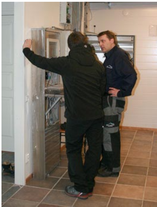
Anläggningen styrs av SWEBO FBR styrsystem.
