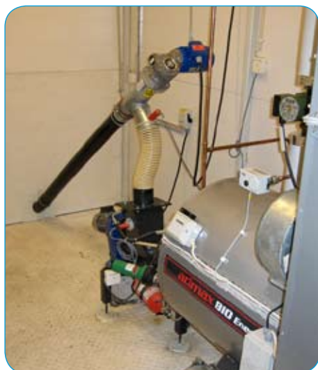
Pelletsskruv och brännare.
