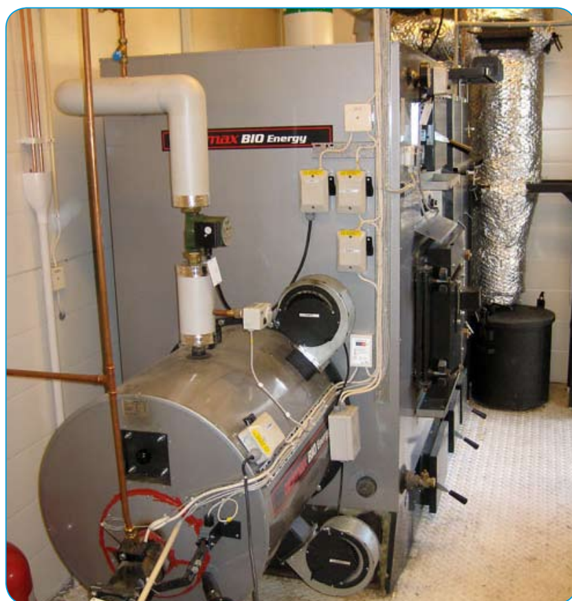
Översiktsbild panna och brännare.
