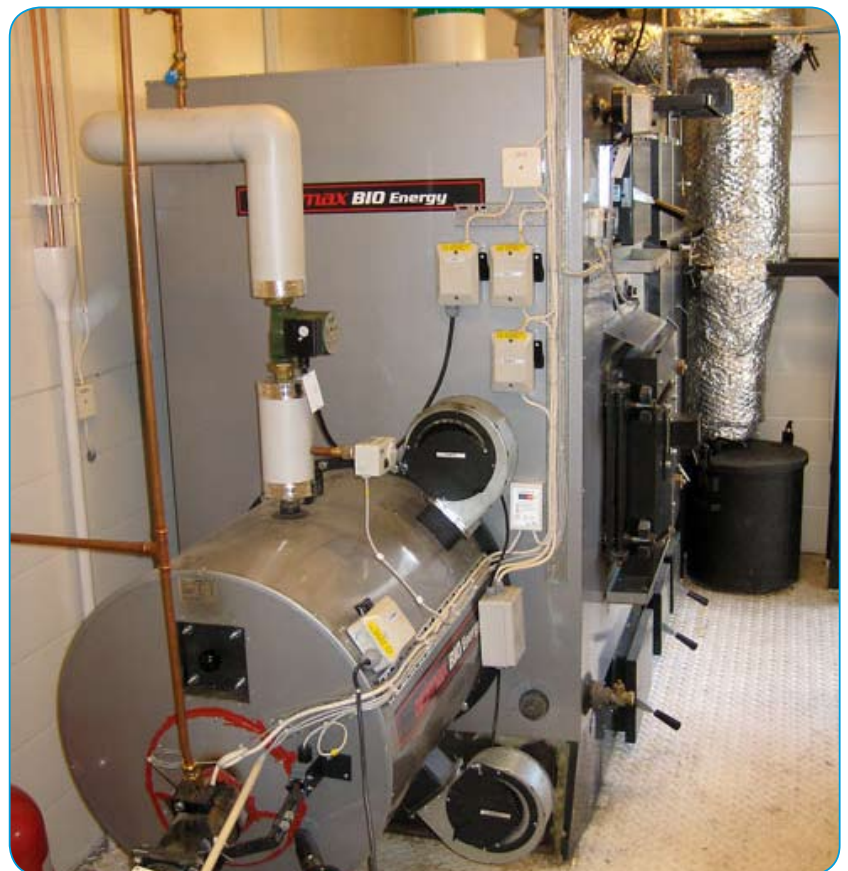
Översiktsbild panna och brännare.
