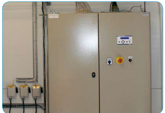
Anläggningen styrs av SWEBO FBS eldningsautomatik.
