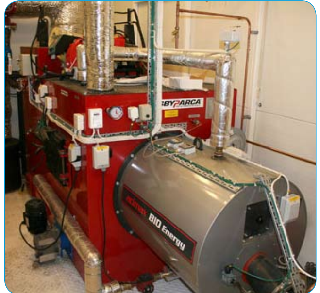
Översiktsbild på panna och brännare.
