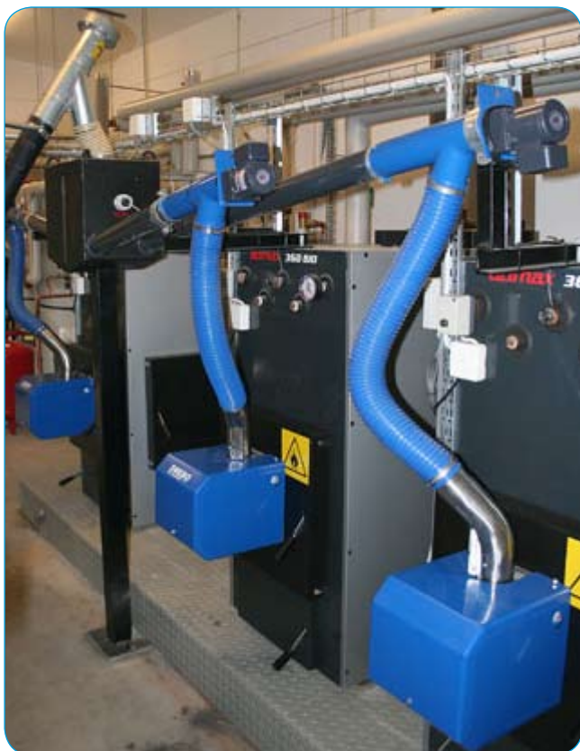
Tre parallellkopplade Arimax 360 pelletspannor samt SWEBO PB/50 pelletsbrännare.
