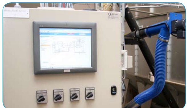
Anläggningen styrs via FBR styrsystem. Just denna styrning reglerar vattenkretsen och dess börvärden. Pelletsbrännarna har varsin styrning som är kopplade till FBS reglercentral.
