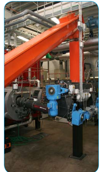
...in till värmeanläggningen.
