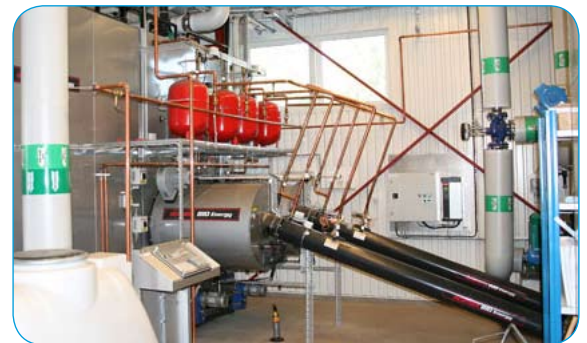
Översiktsbild på de två 500 kW biobrännarna.
