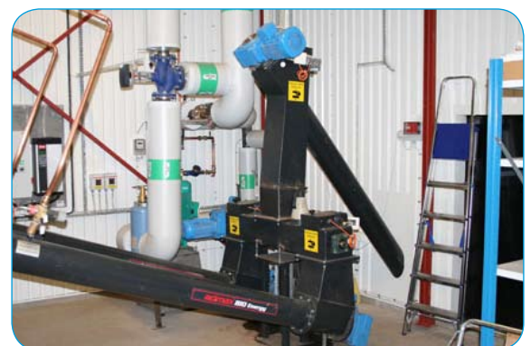
Anslutningen från förråd till matarskruvarna.
