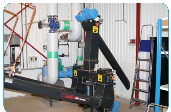
Anslutningen från förråd till matarskruvarna.
