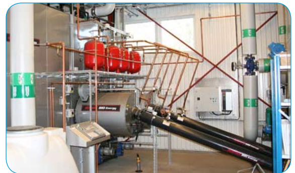
Översiktsbild på de två 500 kW biobrännarna.
