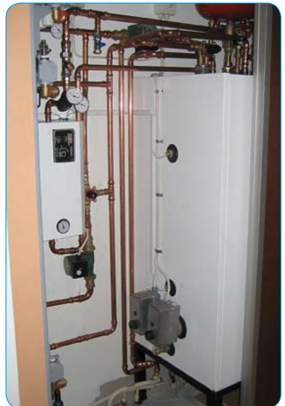
Översiktsbild på anslutningen till elpanna.
