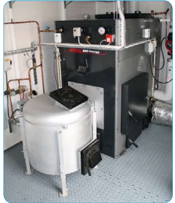
Översiktsbild på SWEBO Energibrännare samt biopanna.
