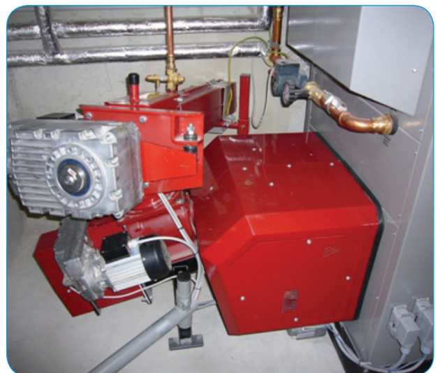
Brännare monterad på pannan.
